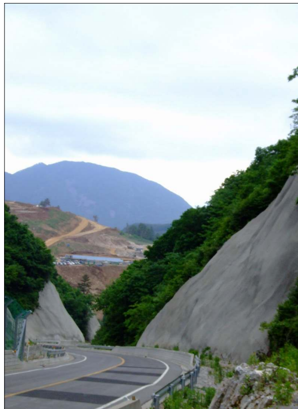
그림 29. 도로공사가 중단된 황조~신리간 도로
