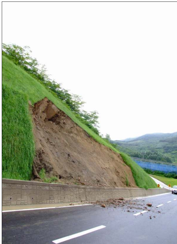
그림 21. 부실공사로 절개면 내려앉은 장수관광순환도로 2구간
