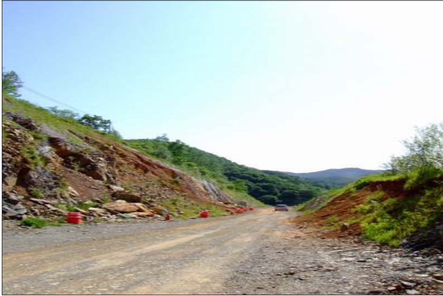
그림 28. 산사태가 발생하여 복구공사중인 북쌍~신천간 도로
