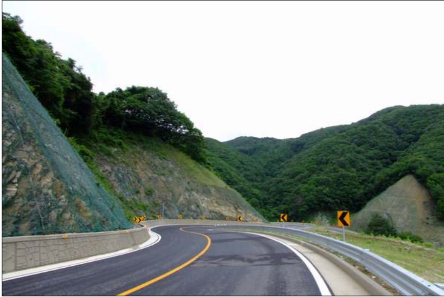
그림 20. 절개면이 심각한 장수관광순환도로 2구간
