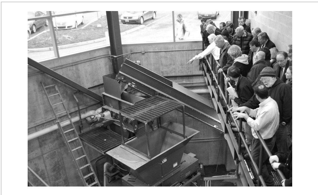
〈그림 20〉 학교에 설치된 바이오가스 생산 공장
