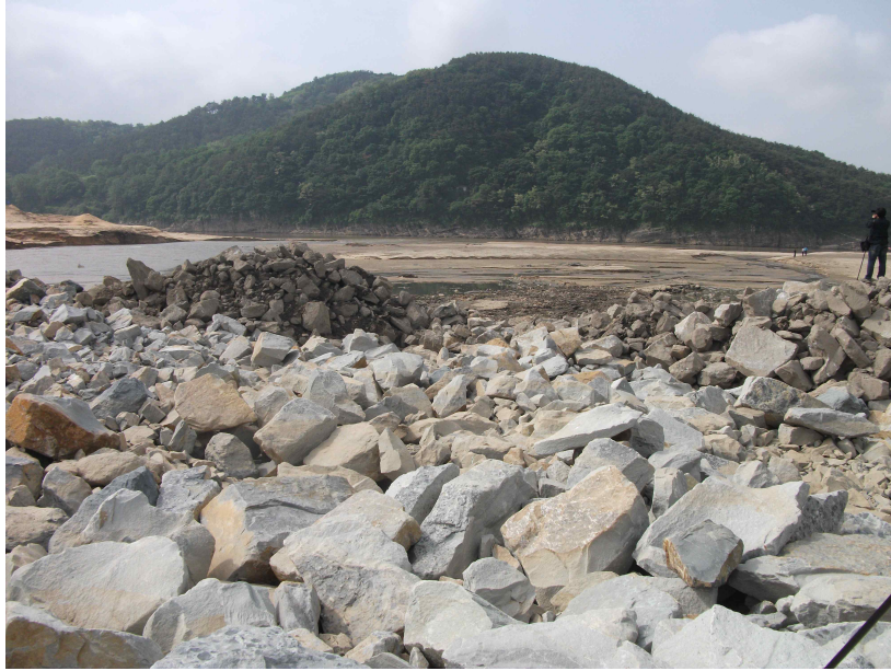
그림 15 낙동강 회천에 설치된 하상보호공 유실
