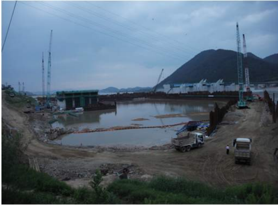
그림 23 합안보 가물막이 유실 및 침수피해
