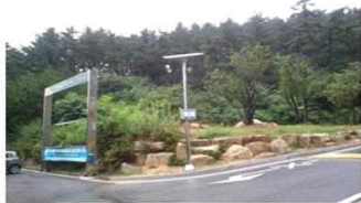
태양광 가로등 설비
