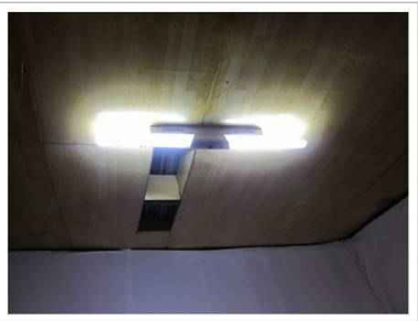
주택내부 천정- 구멍이 있어 슬라브지붕이 보임
